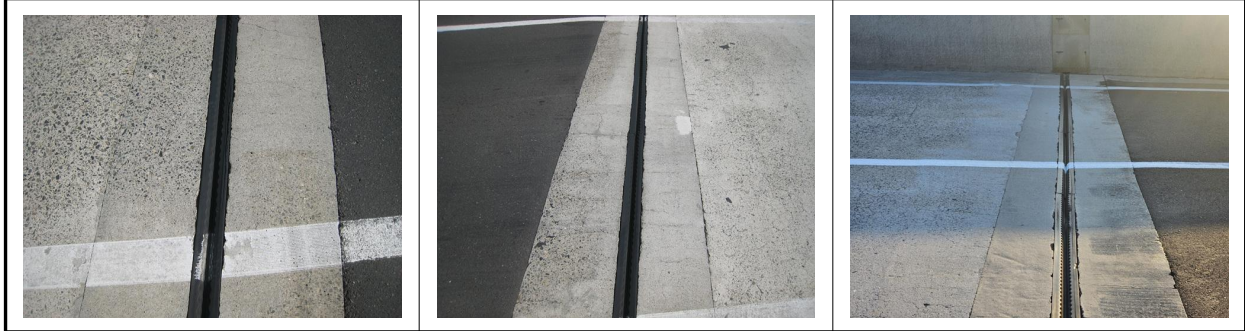
② 신축이음 A1, A2측 후타재 균열, 후타재 박락, 고무재 파손 - 진전 여부확인
